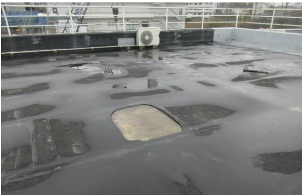
シート剥がれ、ジョイントの剥離
