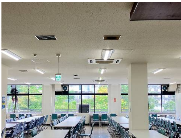
八木山キャンパス食堂空調機 入替前
