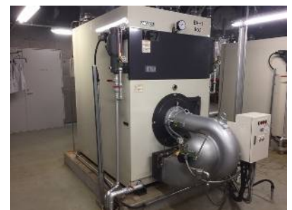
八木山ボイラー写真
